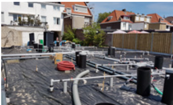
In-situ saneringssysteem Hoensbroek
